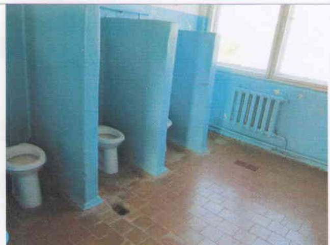
Фото №29 – Санитарно-гигиеническое помещение (туалетные кабины)
